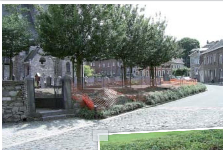
Les vestiges du mur du cimetière entourés de rubalise pour éviter la chute de pierres sur la route.
