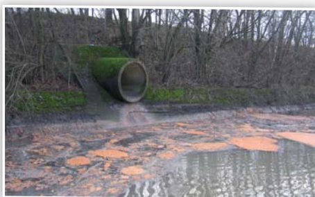
Avant, le bassin d'orage était devenu un dépôt de boues fortement polluées.
