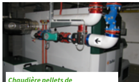
Chaudière pellets de l'Administration communale
